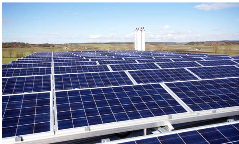
Bild: Photovoltaikanlage auf dem Dach der Klinik
